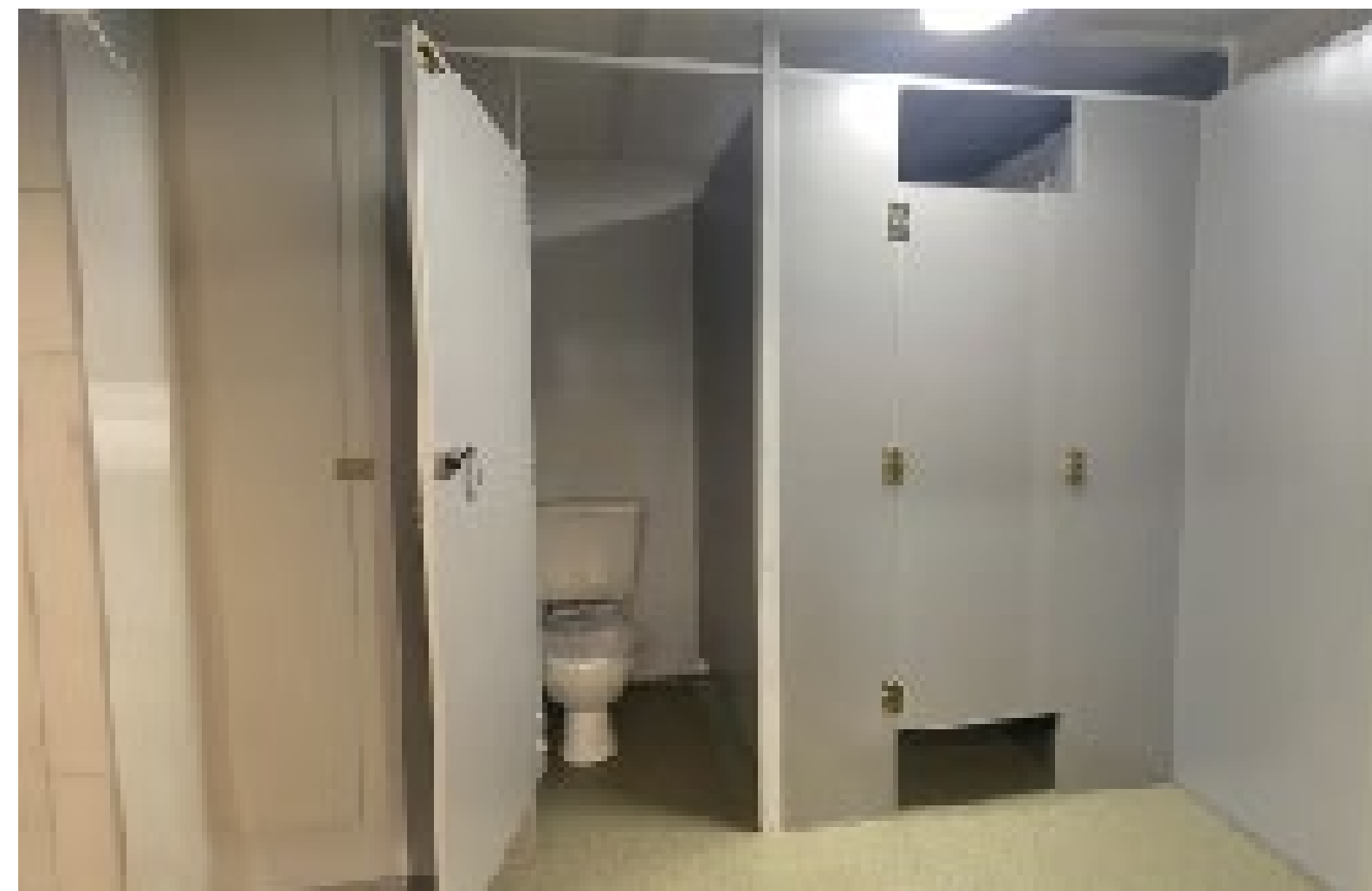
Sanitarios Baños, duchas, vestuarios
